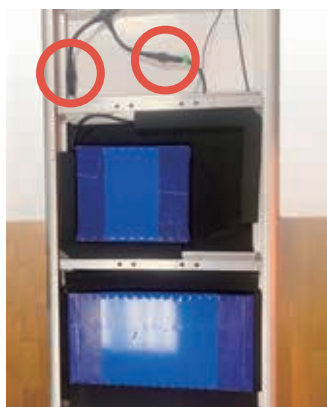
④2カ所のバッテリーコードを取り外します。
